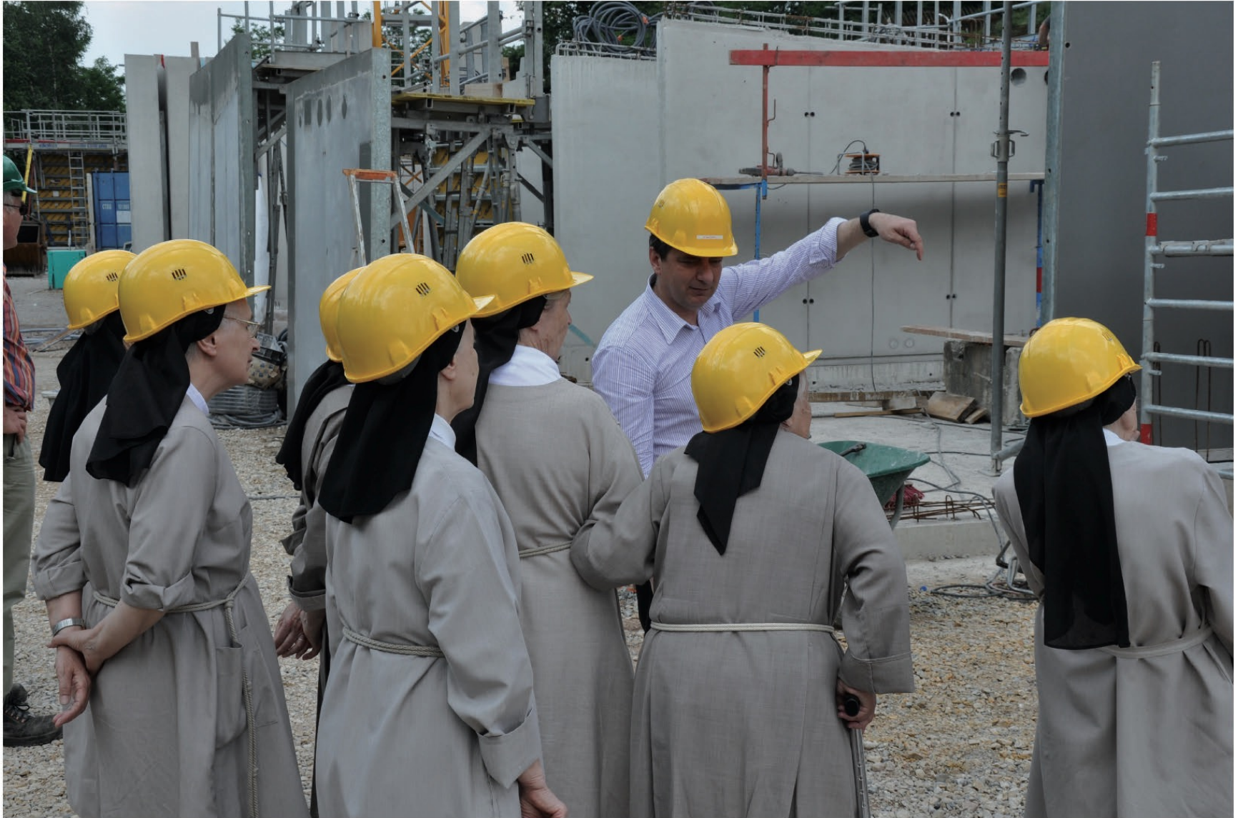
ACCUEIL DES VISITEURS ET MONASTERE DE SAINTE CLAIRE, RONCHAMP RENZO PIANO BUILDING WORKSHOP + ATELIER CORAJOU 2006-2011
